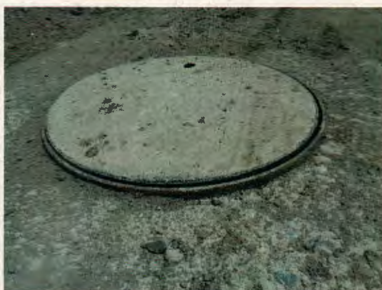
Fotografía N° 42: Refuerzo de hormigón no cubre completamente el anillo metálico de la tapa de la cámara de inspección de alcantarillado público.
