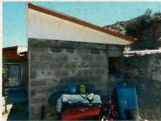
Fotografía N° 51: Beneficiaria MSV. Cubierta no se ajusta a planimetría.
