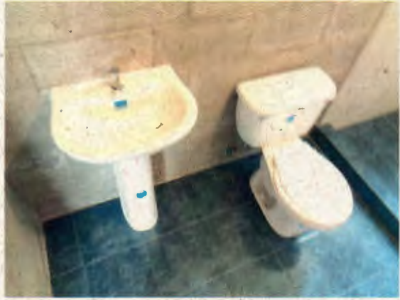
Fotografía N° 58: Beneficiario GSA. Accesorios sanitarios no instalados.
