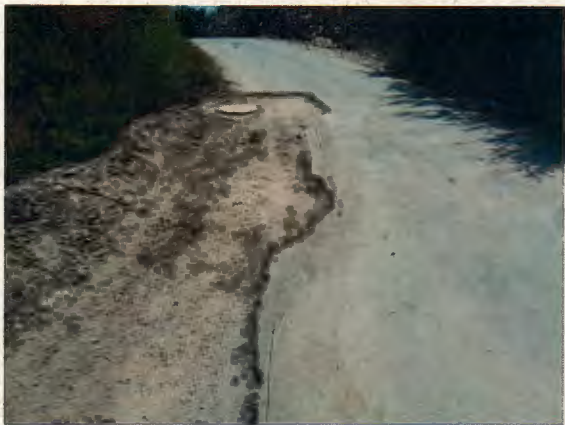
Fotografía N° 46: Refuerzo de hormigón no cubre completamente el anillo metálico de la tapa de la cámara de inspección de alcantarillado público.
