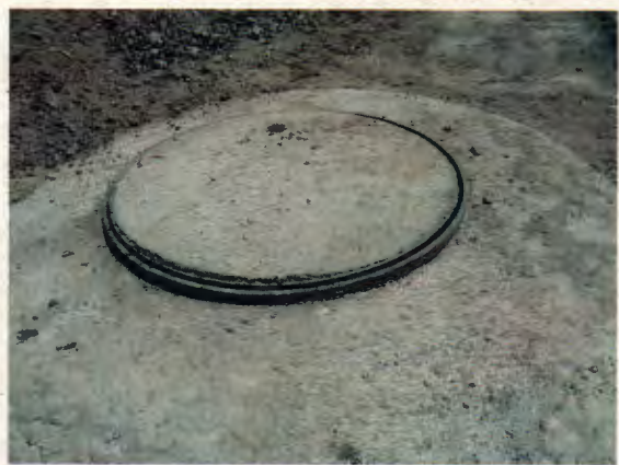
Fotografía N° 44: Refuerzo de hormigón no cubre completamente el anillo metálico de la tapa de la cámara de inspección de alcantarillado público.
