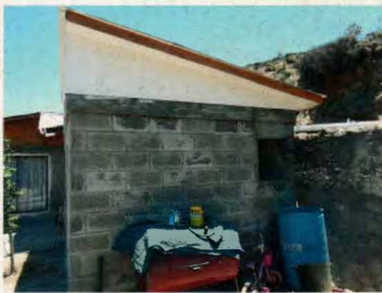
Fotografía N° 66: Beneficiaria MSV. Cubierta no se ajusta a planimetría.
