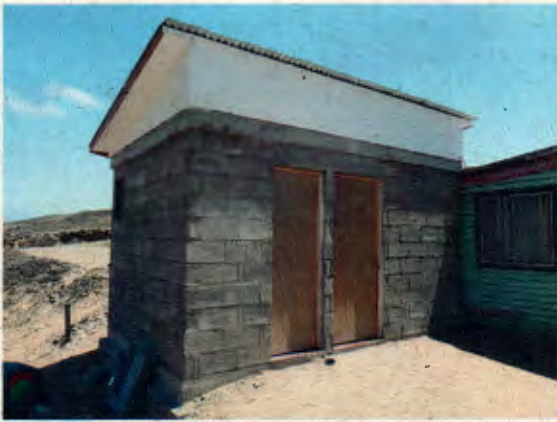
Fotografía N° 59: Beneficiaria DVZ.. Terminación exterior no ejecutada.
