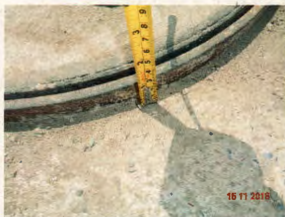
Fotografía N° 40: Refuerzo de hormigón no cubre completamente el anillo metálico de la tapa de la cámara de inspección de alcantarillado público.
