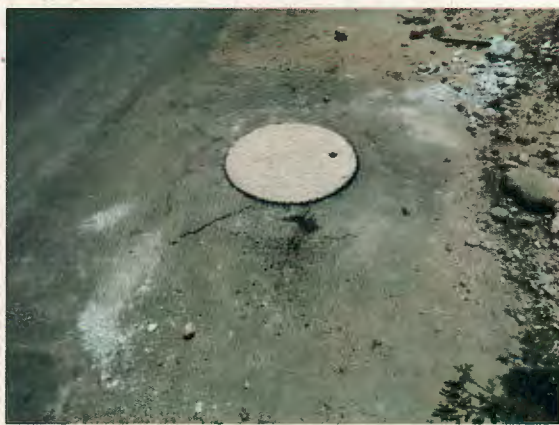
Fotografía N° 37: Grietas en pavimento asfáltico.
