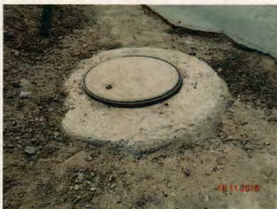
Fotografía N° 39: Refuerzo de hormigón no cubre completamente el anillo metálico de la tapa de la cámara de inspección de alcantarillado público.
