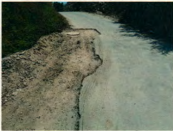
Fotografía N° 73: Ausencia de señalización vial en tramo intervenido.
