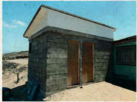
Fotografía N° 50: Beneficiaria DVZ. Terminación exterior no ejecutada.
