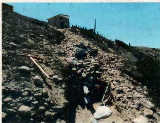
Fotografía N° 62: Beneficiaria DVZ. Partida Alcantarillado no concluida.
