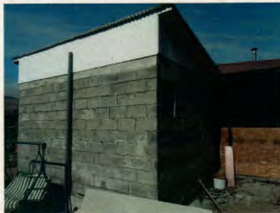
Fotografía N° 26: Tubería de ventilación instalada en vivienda de GSA.
