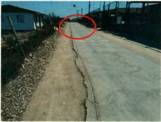
Fotografía N° 75: Sector intervenido sin el reemplazo de señales verticales.
