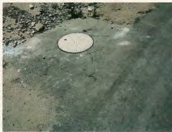
Fotografía N° 38: Grietas en pavimento asfáltico.
