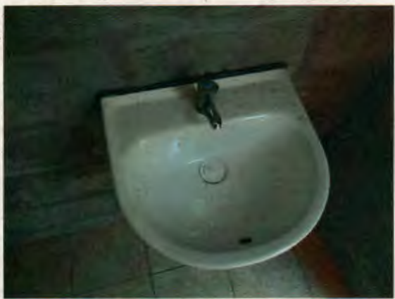
Fotografía N° 63: Beneficiaria DVZ. Accesorios de baño no instalados.
