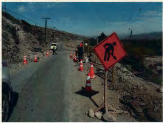
Fotografía N° 68: Personal desarrollando labores sin la utilización de chaleco reflectante.
