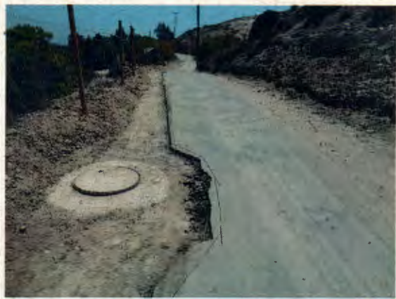
Fotografía N° 43: Refuerzo de hormigón no cubre completamente el anillo metálico de la tapa de la cámara de inspección de alcantarillado público.
