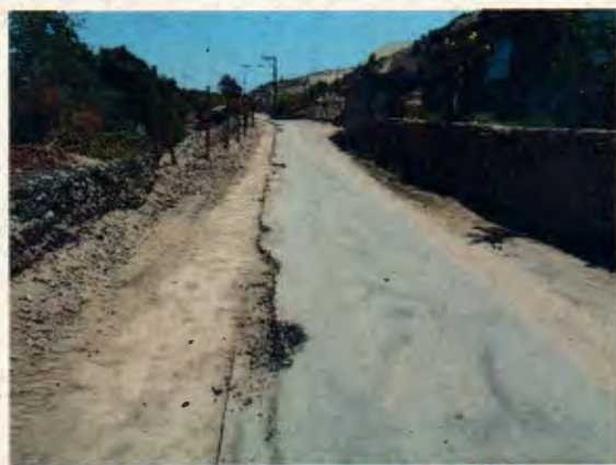
Fotografía N° 71: Ausencia de señalización vial en tramo intervenido.
