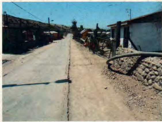
Fotografía N° 69: Ausencia de señalización vial en tramo intervenido.
