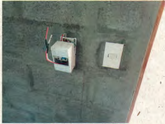
Fotografía N° 56: Beneficiaria EPG. Partida de instalaciones eléctricas no ejecutada completamente.
