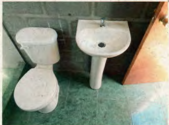
Fotografía N° 54: Beneficiaria EPG. Accesorios de baño no instalados.
