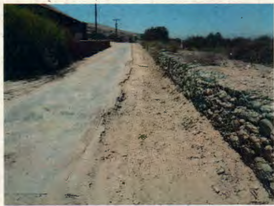
Fotografía N° 72: Ausencia de señalización vial en tramo intervenido.
