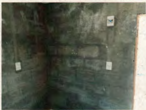
Fotografía N° 61: Beneficiaria DVZ. Partida instalaciones eléctricas no concluidas.
