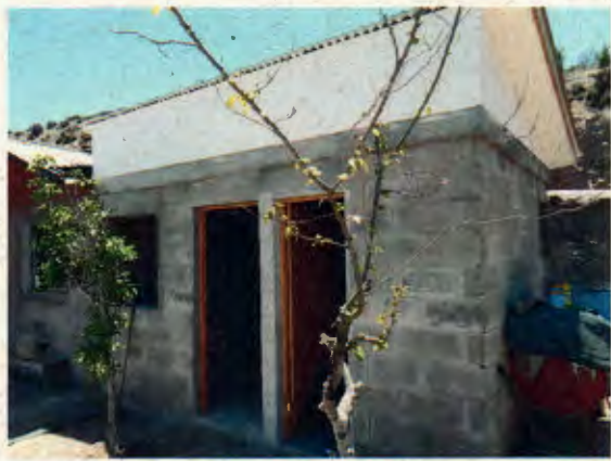
Fotografía N° 67: Beneficiaria MSV. Terminaciones exteriores no ejecutadas.
