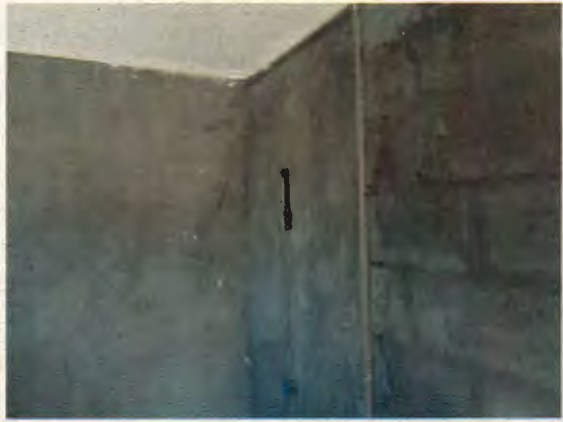
Fotografía N° 60: Beneficiaria DVZ. Accesorios sanitarios no instalados.
