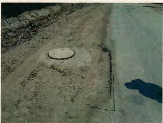
Fotografía N° 41: Refuerzo de hormigón no cubre completamente el anillo metálico de la tapa de la cámara de inspección de alcantarillado público.
