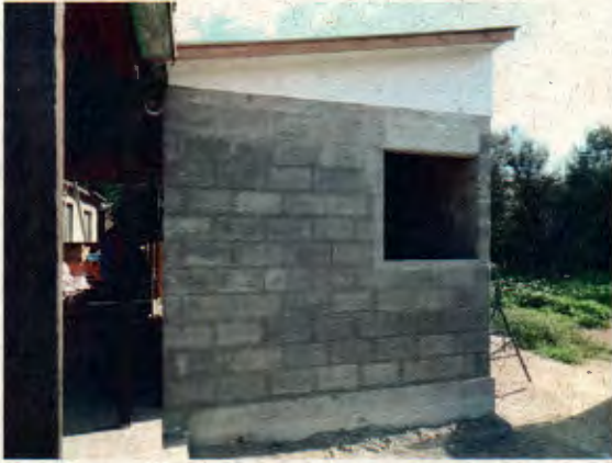
Fotografía N° 57: Beneficiario GSA. Terminación exterior no ejecutada.
