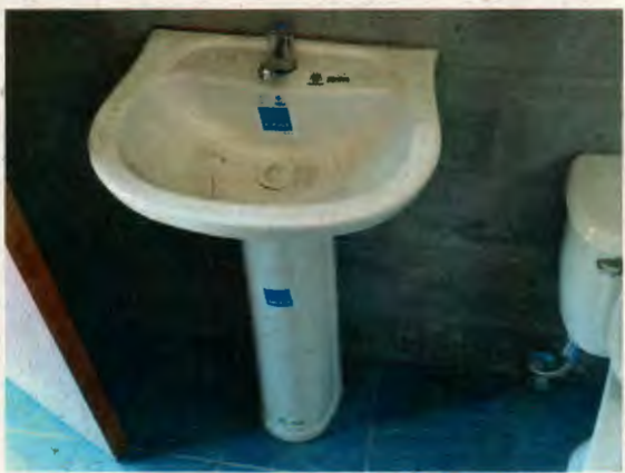
Fotografía N° 65: Beneficiaria MSV. Accesorios sanitarios no instalados.
