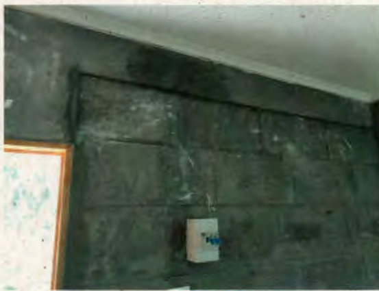
Fotografía N° 64: Beneficiaria JVF. Partida de instalaciones eléctricas no concluida.
