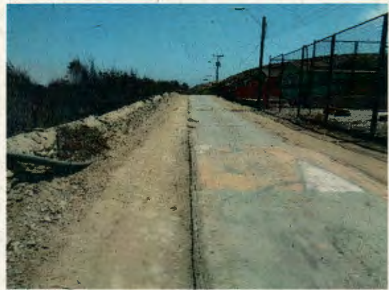
Fotografía N° 74: Sector intervenido sin el reemplazo de señales verticales.
