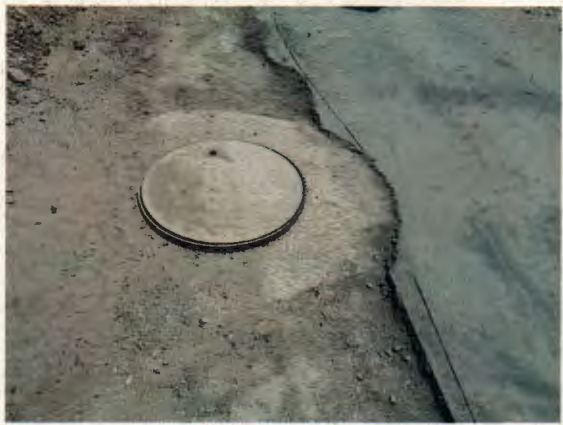
Fotografía N° 45: Refuerzo de hormigón no cubre completamente el anillo metálico de la tapa de la cámara de inspección de alcantarillado público.
