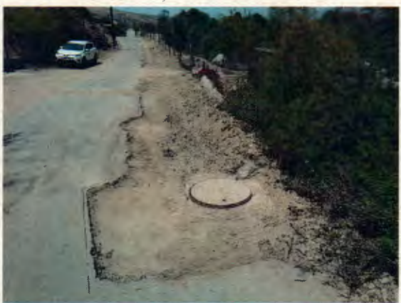
Fotografía N° 47: Refuerzo de hormigón no cubre completamente el anillo metálico de la tapa de la cámara de inspección de alcantarillado público.
