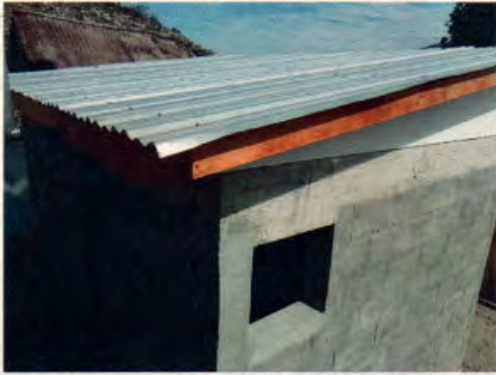
Fotografía N° 55: Beneficiaria EPG. Terminación exterior no ejecutada.
