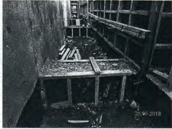
Fotografía N° 20: Pasillo colindante y paralelo al muro del eje A -bajo el sector de graderías-, sin rampas que otorguen una mayor seguridad para el personal.
