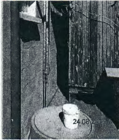
Fotografía N° 44: Ductos de agua caliente sin la protección adecuada. Caseta sanitaria 4, MZ "B".
