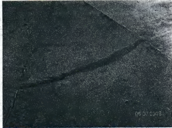
Fotografía N° 14: Fisuras en pavimento del estacionamiento vehicular, por calle Mateo Palacios.
