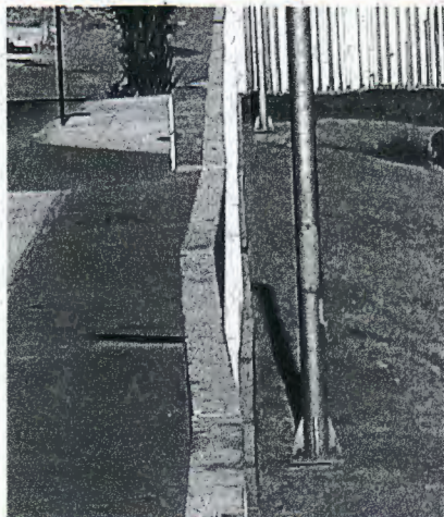
Fotografía N° 7: Reja metálica perimetral paralela a la calle Isla Nueva, no se encuentra perfectamente alineada.
