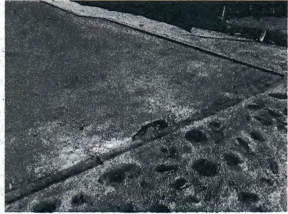
Fotografía N° 56: Rotura de pavimento asfáltico en zona ubicada al término del pasaje 2.
