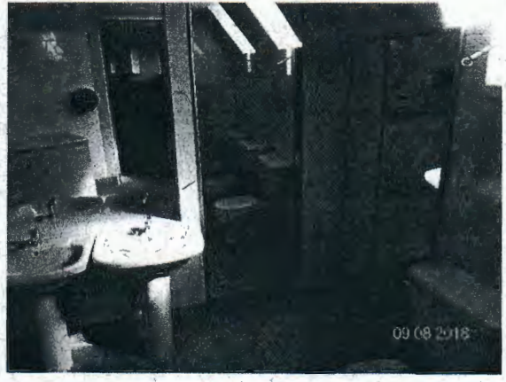
Fotografía N° 63: Sala de hábitos higiénicos sin que se encuentren ejecutados los estantes identificados en plano.
