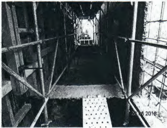
Fotografía N° 21: Pasillo colindante y paralelo al muro del eje A -bajo el sector de graderías-, sin rampas que otorguen una mayor seguridad para el personal.
