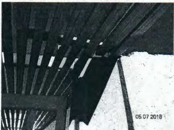
Fotografía N° 5: Mala terminación en de portón metálico de la salida (intersección de las calles Ejército Libertados e Isla Nueva).
