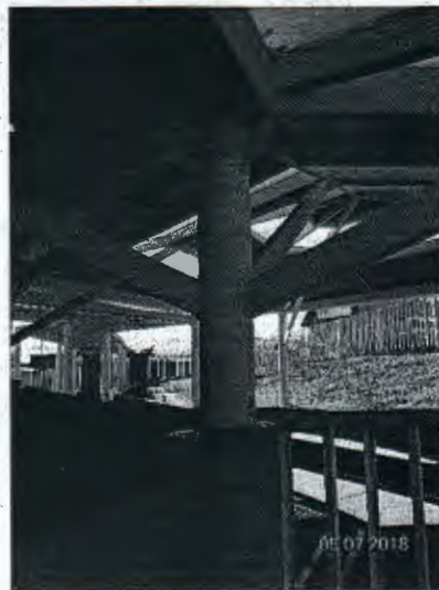
Fotografía N° 24: Goteras desde las canaletas de aguas lluvias.
