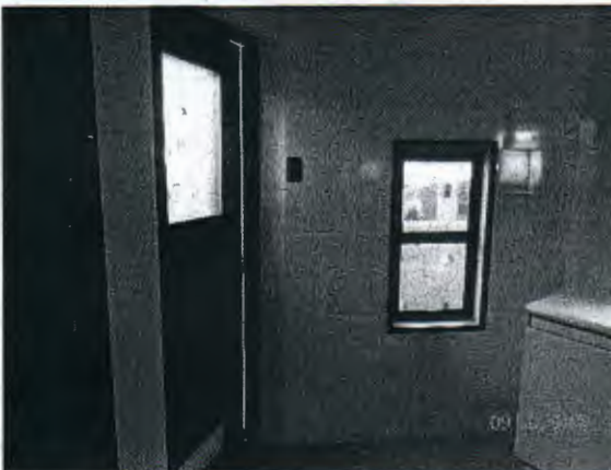
Fotografía N° 45: Puertas de cocinas sin malla mosquitera.
