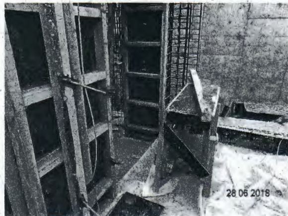
Fotografía N° 24: Elementos metálicos salientes que representan un peligro para los trabajadores que transitan por dicho lugar.
