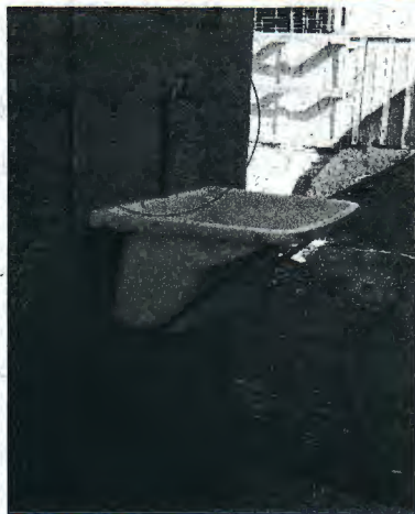
Fotografía N° 13: Falta de espejuelo en zona de lavadero. Caseta sanitaria 7, MZ "C".
