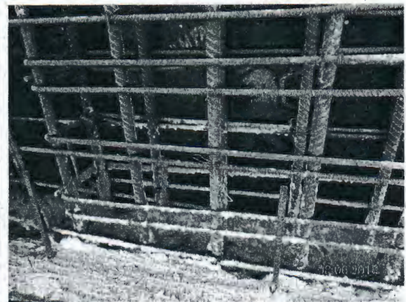
Fotografía N° 16: Enfierraduras montadas con restos de hormigón.
