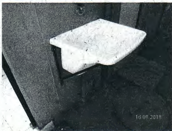
Fotografía N° 15: Falta de espejuelo en zona de lavadero. Caseta sanitaria 8, MZ "B".
