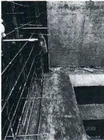
Fotografía N° 23: Elementos metálicos salientes que representan un peligro para los trabajadores que transitan por dicho lugar.
