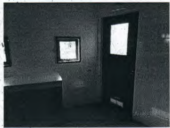
Fotografía N° 46: Puertas de cocinas sin malla mosquitera.
