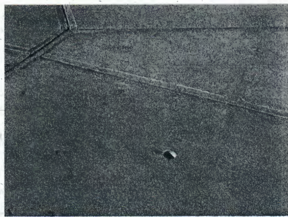
Fotografía N° 18: Zonas de aceras peatonales en las cuales se extrajeron testigos de hormigón endurecido y que3 no se encuentran sellados.
