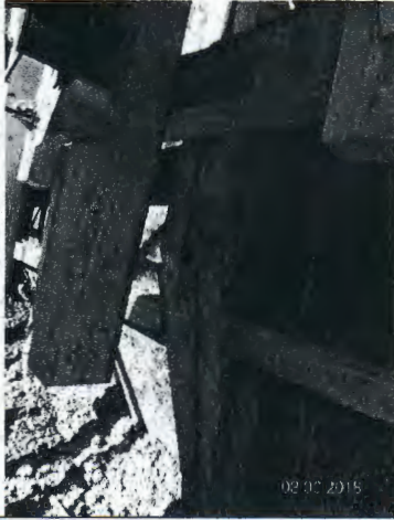
Fotografía N° 19: Deformación de moldaje en muro hormigonado en el eje 1 del sector de graderías.
