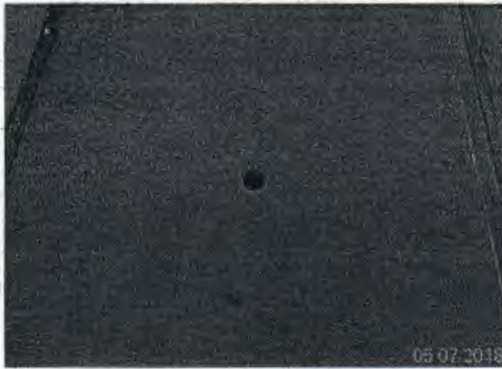
Fotografía N° 19: Zonas de aceras peatonales en las cuales se extrajeron testigos de hormigón endurecido y que no se encuentran sellados.
