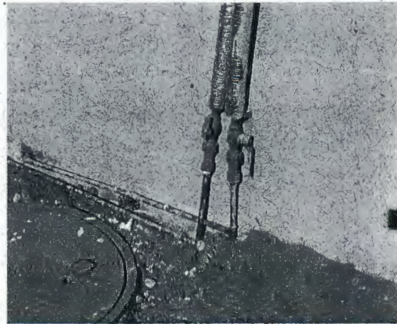
Fotografía N° 46: Ductos de agua caliente sin la protección adecuada. Caseta sanitaria 4, MZ "C".
