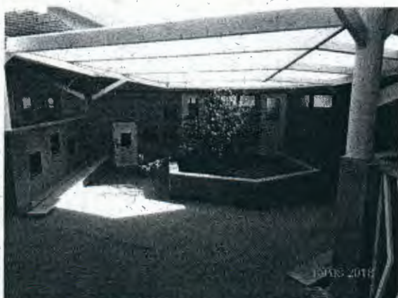
Fotografía N° 52: Puertas sin señaléticas que identifiquen los recintos.
