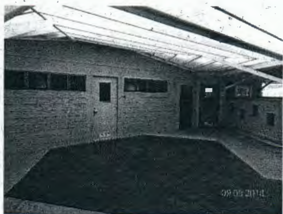
Fotografía N° 51: Puertas sin señaléticas que identifiquen los recintos.
