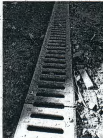
Fotografía N° 22: Canaleta ranurada de la red de aguas lluvias con presencia de óxido.
