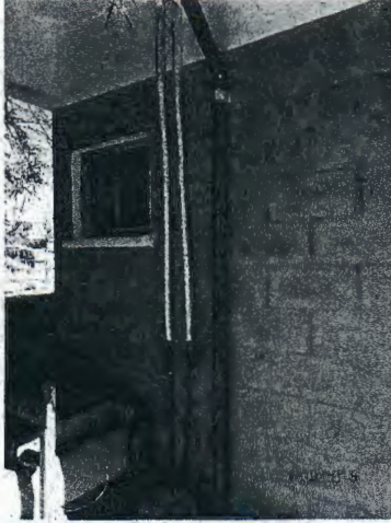
Fotografía N° 43: Ductos de agua caliente sin la protección adecuada. Caseta sanitaria 3, MZ "B".
