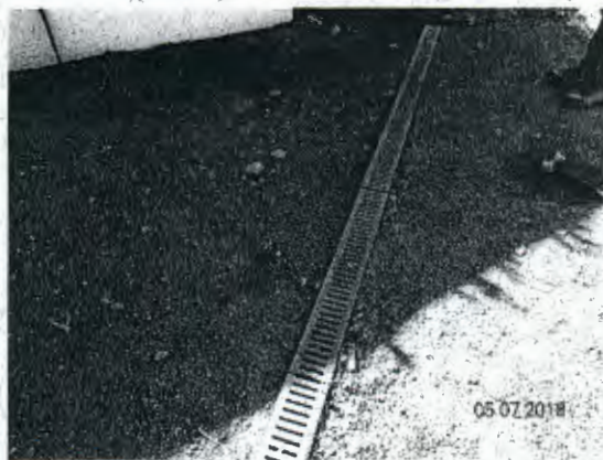
Fotografía N° 21: Canaleta ranurada de la red de aguas lluvias con presencia de óxido.
