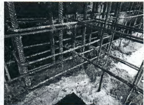
Fotografía N° 17: Enfierraduras montadas con restos de hormigón.
