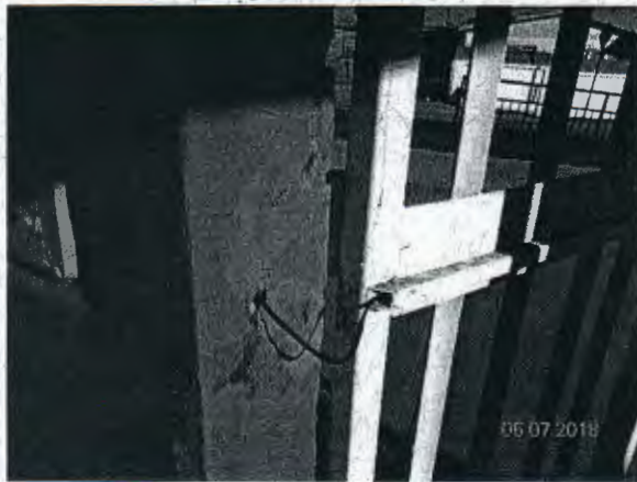
Fotografía N° 20: Cable que pasa entre el muro de hormigón y la reja metálica del acceso principal, sin protección adecuada.
