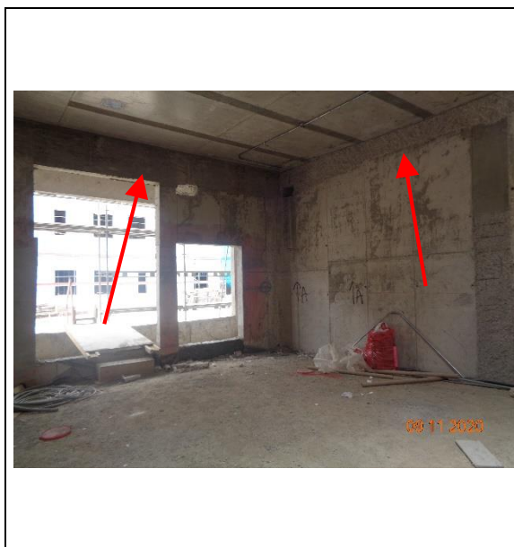
Fotografía N°: 76 Fecha captura: 9 de noviembre de 2020. Ubicación: Sala grupo electrógeno y sala de bombas, edificio C. Contenido: Enfierradura a la vista.
