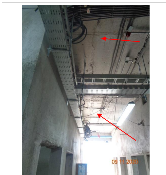
Fotografía N°: 11 Fecha captura: 9 de noviembre de 2020. Ubicación: Edificio C. Contenido: Fisura parte exterior, inferior e interior viga superior en eje J y losa, hasta el eje P1, entre los ejes 6C y 7C.
