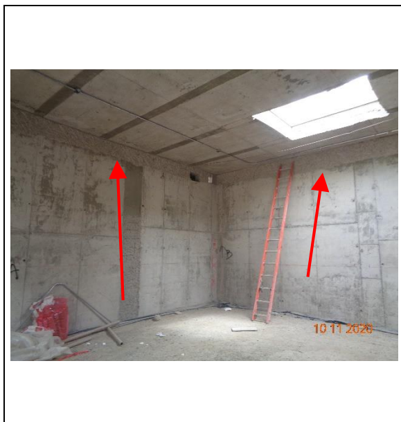
Fotografía N°: 77 Fecha captura: 10 de noviembre de 2020. Ubicación: Sala grupo electrógeno y sala de bombas, edificio C. Contenido: Enfierradura a la vista.
