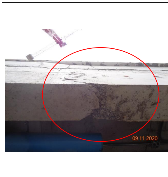
Fotografía N°: 9 Fecha captura: 9 de noviembre de 2020. Ubicación: Edificio C. Contenido: Fisura parte exterior, inferior e interior viga superior en eje J y losa, hasta el eje P1, entre los ejes 6C y 7C.
