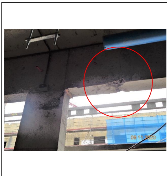
Fotografía N°: 8 Fecha captura: 9 de noviembre de 2020. Ubicación: Edificio C. Contenido: Fisura parte exterior, inferior e interior viga superior en eje J y losa, hasta el eje P1, entre los ejes 6C y 7C.
