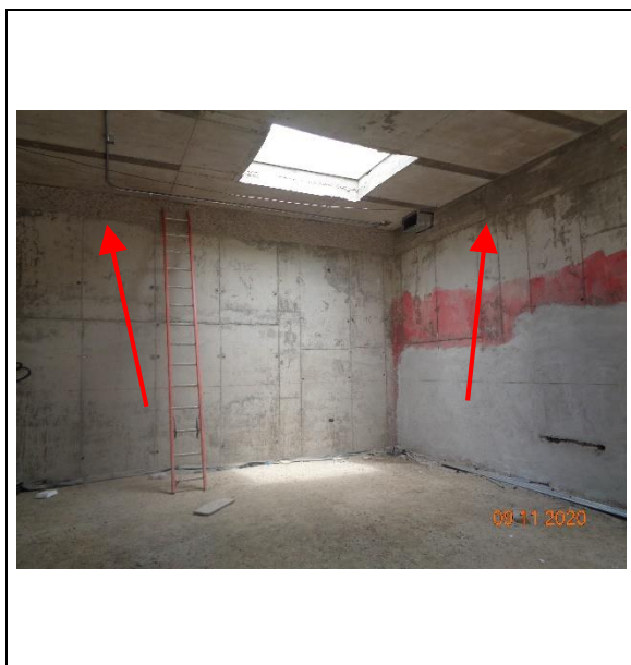
Fotografía N°: 75 Fecha captura: 9 de noviembre de 2020. Ubicación: Sala grupo electrógeno y sala de bombas, edificio C. Contenido: Enfierradura a la vista.
