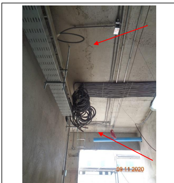
Fotografía N°: 10 Fecha captura: 9 de noviembre de 2020. Ubicación: Edificio C. Contenido: Fisura parte exterior, inferior e interior viga superior en eje J y losa, hasta el eje P1, entre los ejes 6C y 7C.
