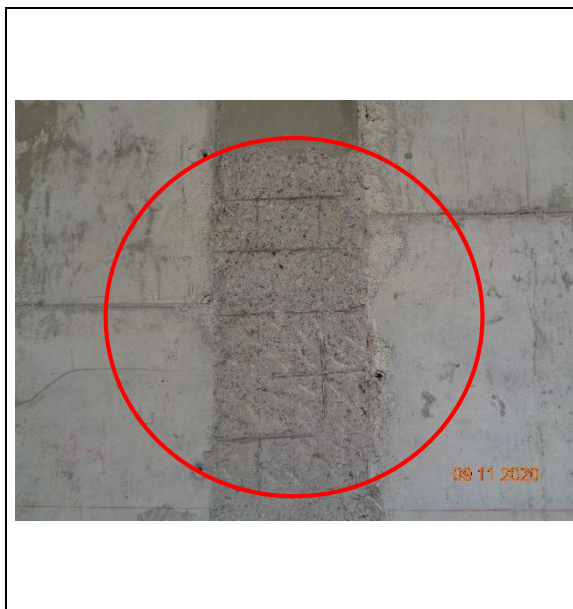
Fotografía N°: 78 Fecha captura: 9 de noviembre de 2020. Ubicación: Sala grupo electrógeno y sala de bombas, edificio C. Contenido: Enfierradura a la vista.
