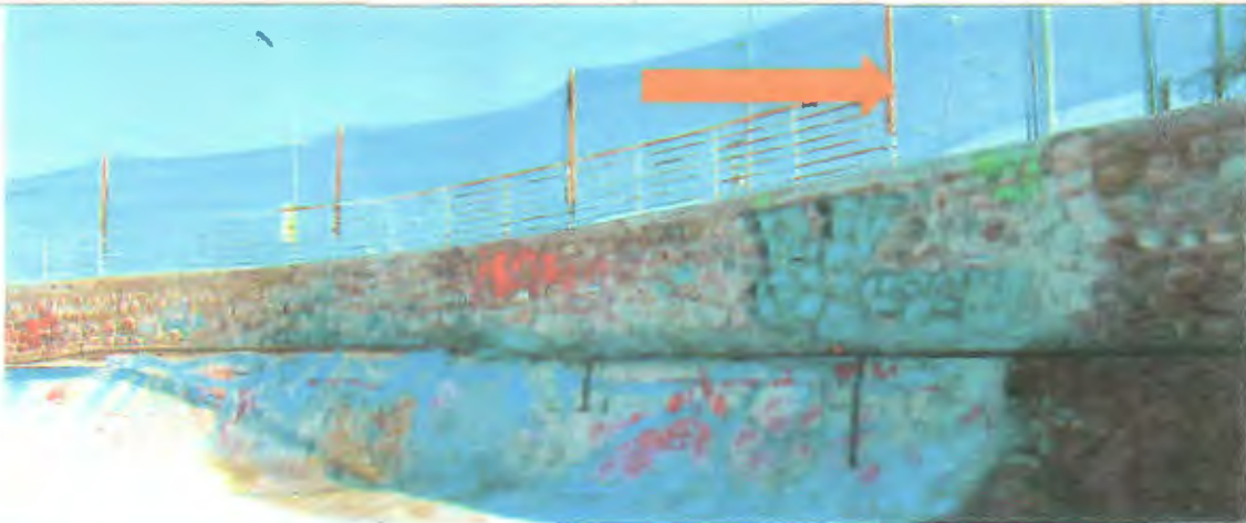
Ilustración 16: Ausencia de perfiles en baranda existente.
