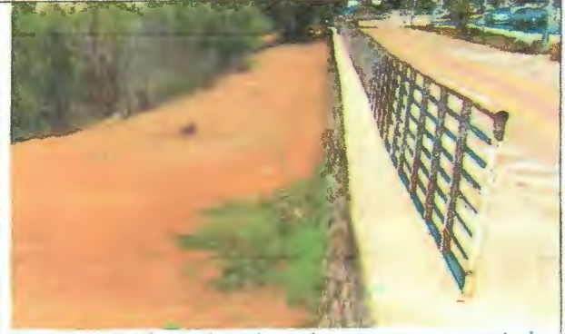
Ilustración 18: Corrosión en barandas existentes, y ausencia de perfiles.
